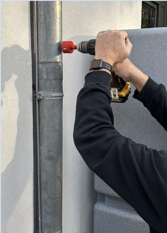
Lochbohrung an Fallrohr und Tonne
